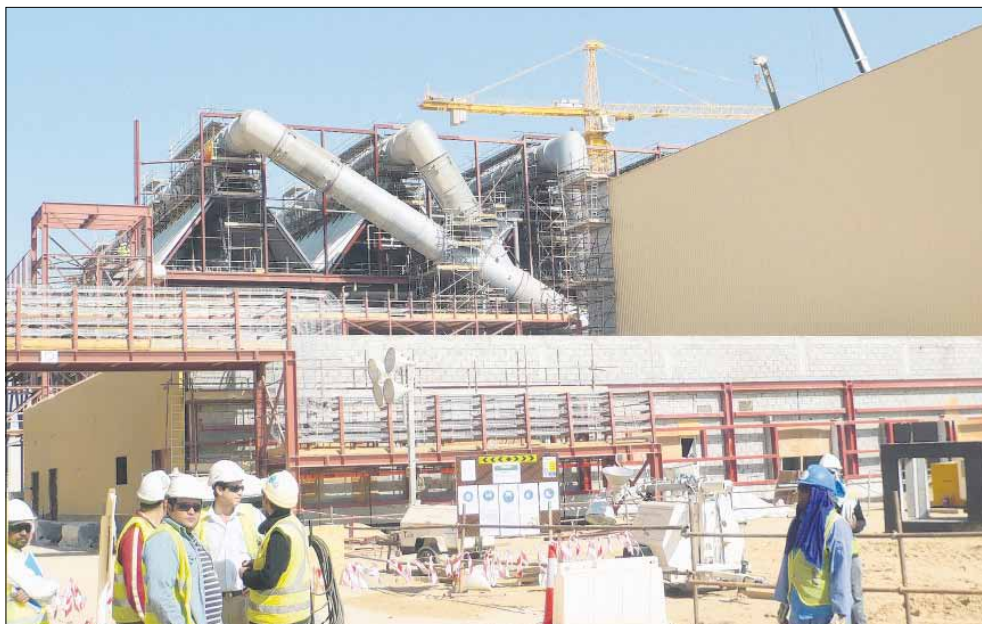
Kühltechnologie für das Solarkraftwerk Shams 1: Das 100-MW-Kraftwerk in den Vereinigten Arabischen Emiraten baut auf Luftkühlung. Aus der Dampfturbine - untergebracht in der gelben Halle (links) - strömt der Abdampf durch fünf gewaltige Rohre in fünf parallele angeordnete Kondensatorreihen. Foto: Masdar
