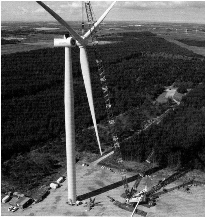
Windriese im Test: Seit Mai dieses Jahres dreht sich der Prototyp einer Sieben-Megawatt-Turbine SWT-7.0-154 von Siemens im dänischen Versuchsfeld Østerild.
