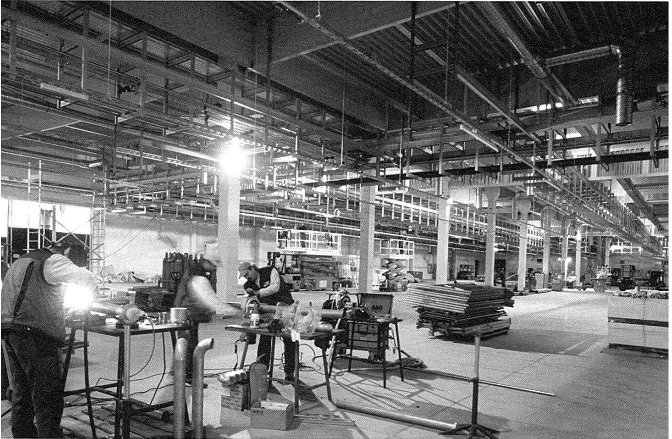
MEN AT WORK: Bei der Q-Cells AG im brandenburgischen Thalheim wird emsig am Ausbau der Produktionshallen gearbeitet.
