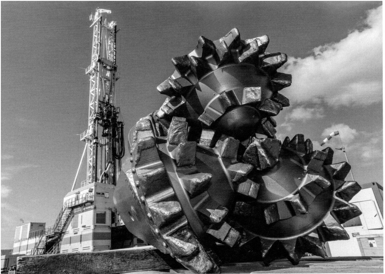
Ehrgeiziges Bohrprojekt: Die Stadtwerke München setzen auf Geothermie. Zurzeit graben sie in München-Freiham eine 2000 Meter tiefe Röhre ins Erdreich, um sich dort im Untergrund eine neue Wärmequelle zu erschließen.
