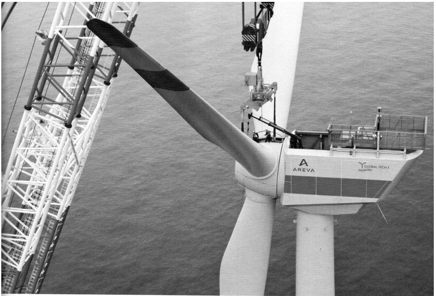
Meer-Investition: Viele Stadtwerke beteiligen sich inzwischen an Offshore-Anlagen wie dem Windpark Global Tech 1 in der Nordsee.
