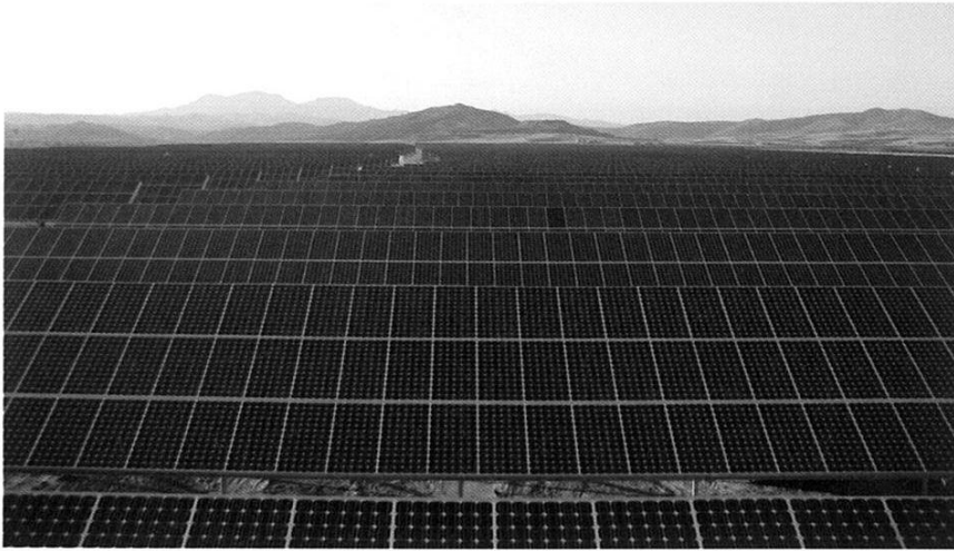
■ Grenzenlos solar: Die aus kristallinen Modulen der Firma Aleo Solar bestehende Freilandanlage Vidana mit vier Megawatt Leistung ist nur eines von vielen Solarkraftwerken in Spanien. Bild: Aleo Solar
