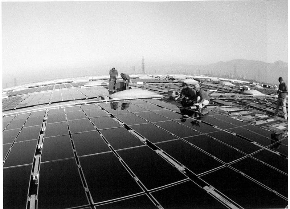
■ Dünnschicht für US-Dächer: Vor allem in Kalifornien entstehen derzeit überall Solarkraftwerke. Auf diesem Dach in Fontana werden zwei Megawatt First Solar-Module verbaut.
