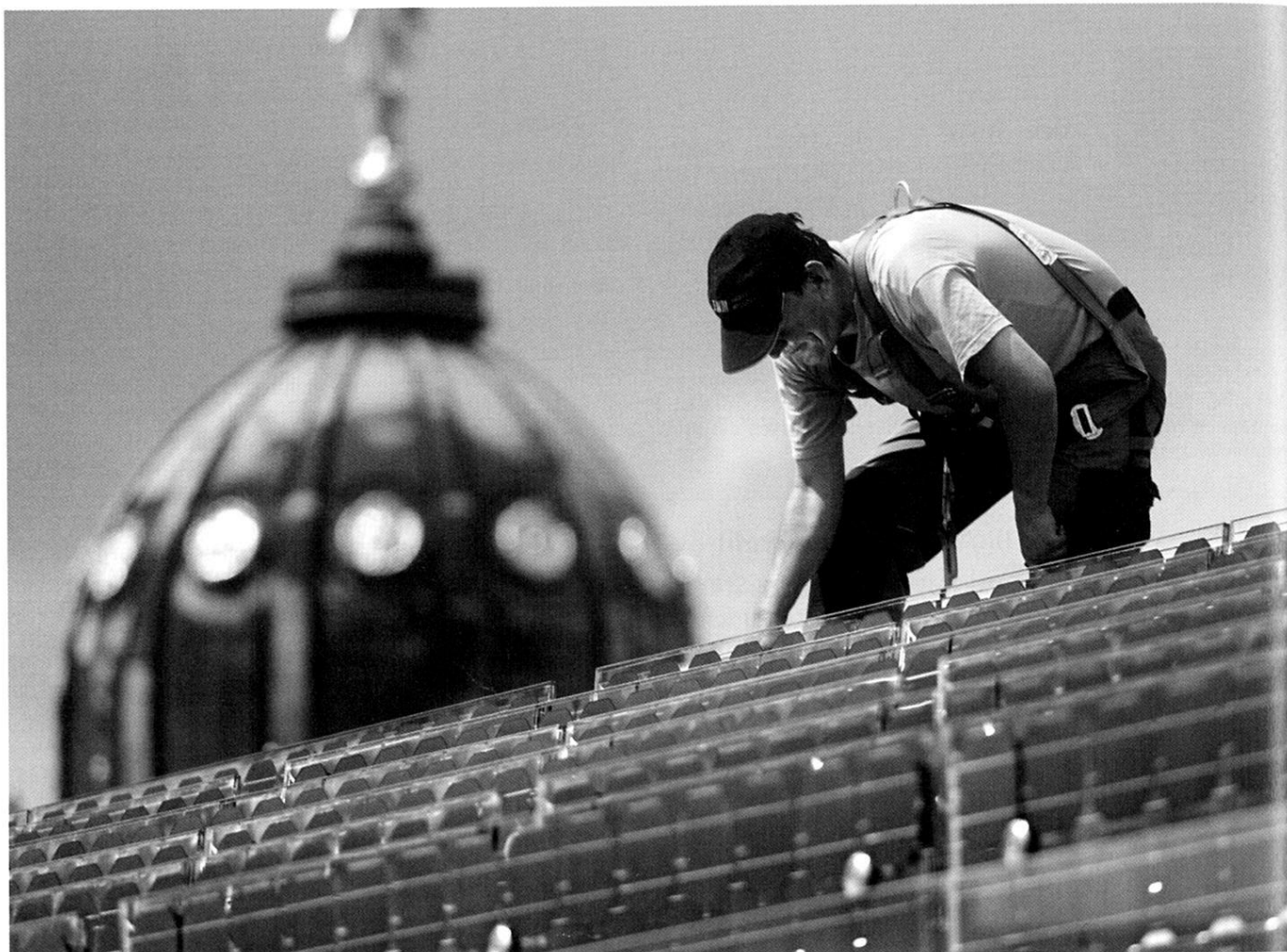
Berlin in Blau: Kristalline Siliciumzellen sind in Deutschland die führende PV-Technik. Auch auf dem Dach des Bundesjustizministeriums entsteht ein Sonnenkraftwerk. Bild: Justizministerium/Paul Langrock
