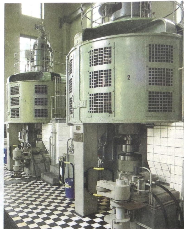
Angetrieben von einer Francis- und einer Kaplan turbine, erzeugen die Generatoren im Kraftwerk Ohl Grünscheid zusammen etwa 4,5 Mio. kWh elektrische Energie pro Jahr.
