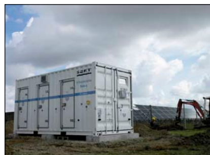
Bild 2: Batteriemodul im Container auf dem SmartRegion Gelände
