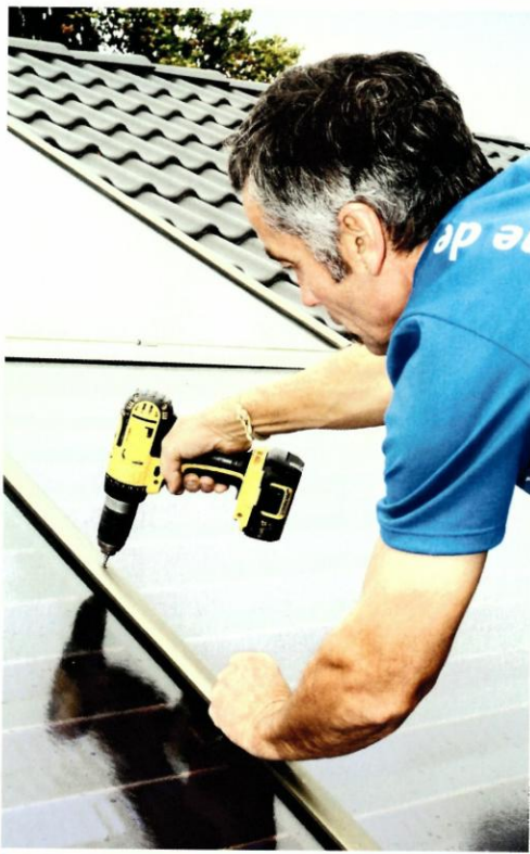
Teure Arbeit: Hohe Installationskosten treiben die Preise bei der Solarthermie.
