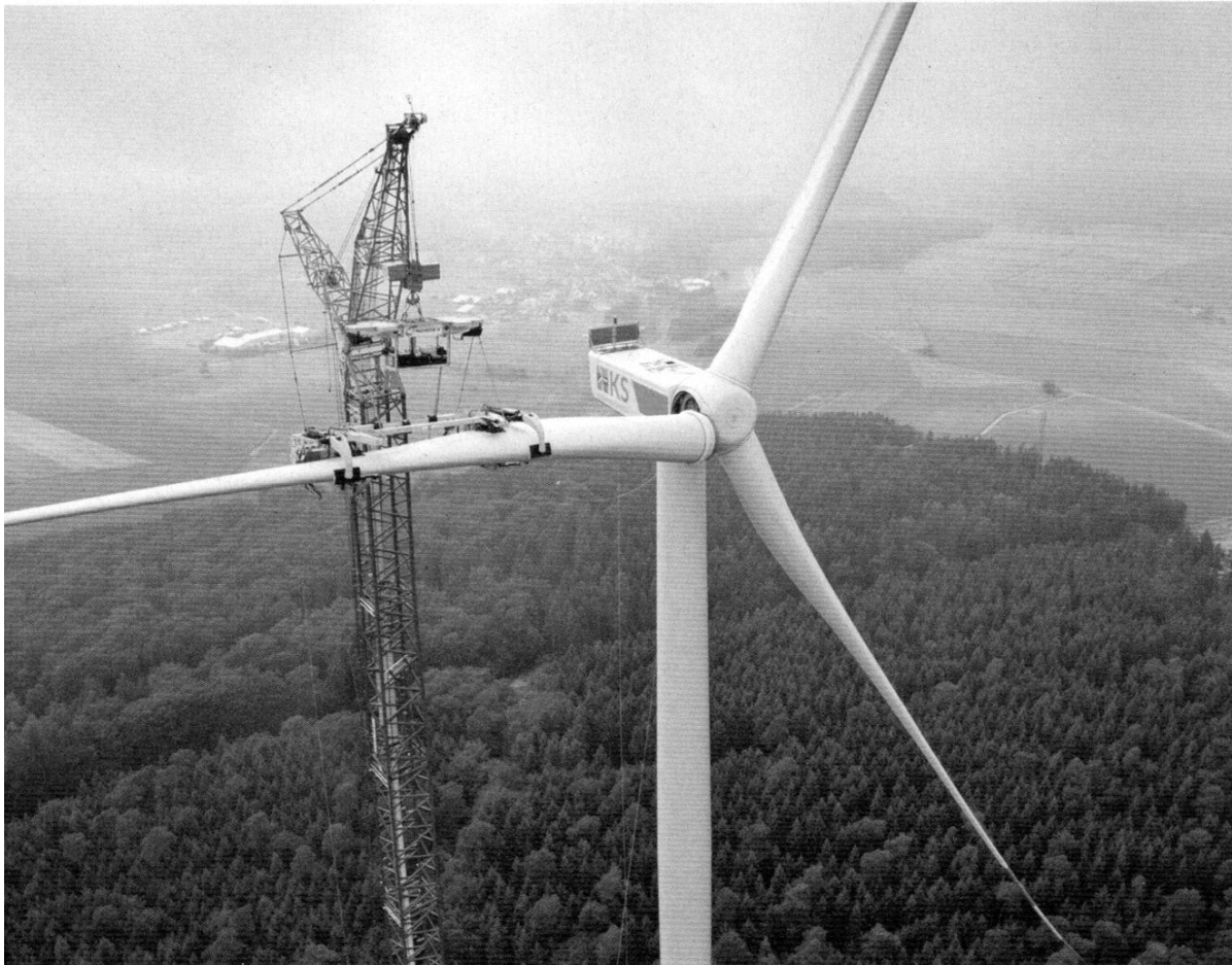
Hoch hinaus: Nordex führt derzeit den 164-Meter-Turm in den Markt ein, um Schwachwind-Standorte erschließen zu können.
