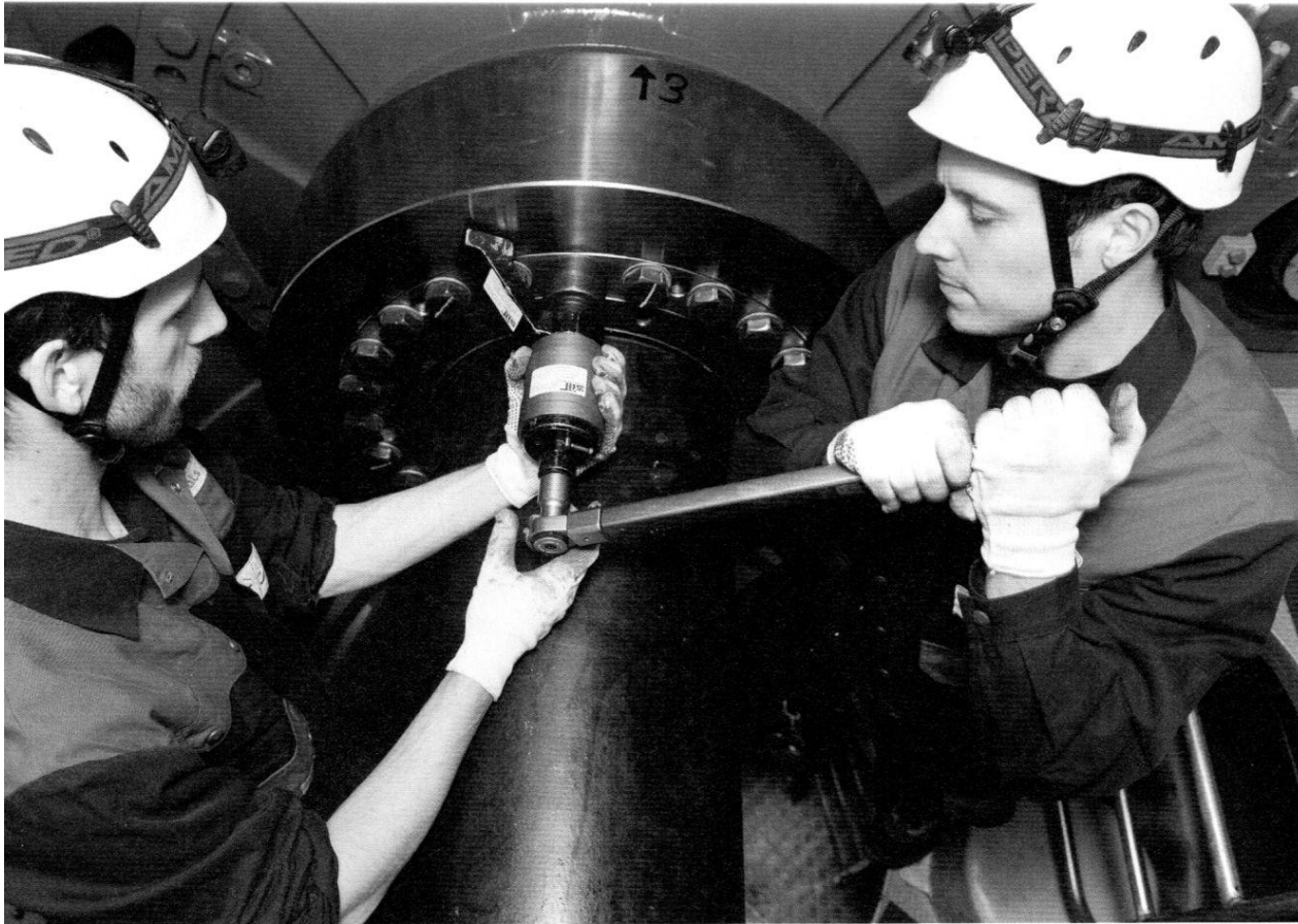
Alles im Griff: Experten des Serviceanbieters PSM bei Wartungsarbeiten an der Rotorwelle einer Windkraftanlage.
