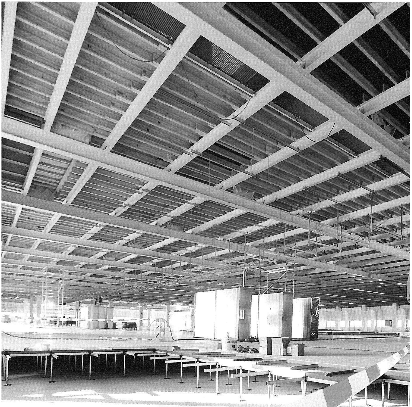
Einzug in die alte Chipfabrik: Der Umbau ist abgeschlossen, jetzt kann Photovoltaikhersteller Conergy seine Maschinen in der 30.000 Quadratmeter großen Halle installieren.
