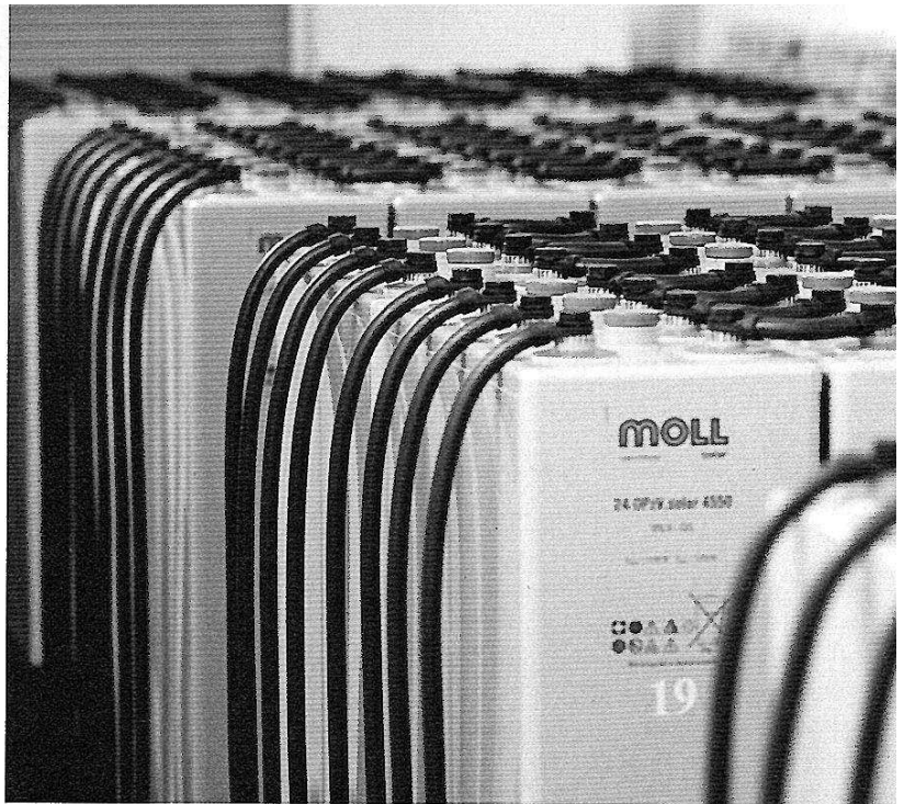
Quartierspeicher: Eine Großbatterie mit 330 Kilowattstunden Kapazität nimmt in Hof-Epplas Stromüberschüsse von 13 Solaranlagen auf.
