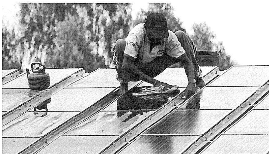
Unten: Was anderswo die Schneelast ist, ist in Afrika der Staub. Um die Leistung der Solarmodule zu gewährleisten, müssen sie regelmäßig gereinigt werden.
