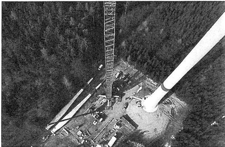
Abb. 1: Aufbau einer Servion 3.2.M/114 im Windpark Beltheim an einem Waldstandort im Hunsrück
