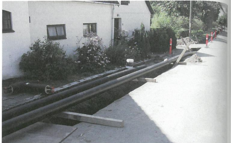
Buddeln für die Energiewende: In den vergangenen Monaten haben die Einwohner Samsøs ein neues Nahwärmenetz verlegt.
