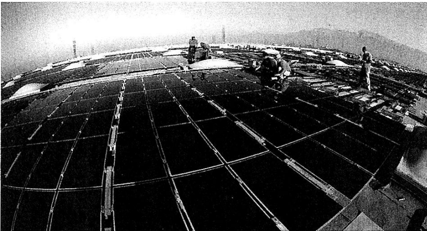
Große Sonnenernte: Installateure verwandeln das Dach einer Fabrikhalle in Kalifornien in ein leistungsstarkes Solarkraftwerk.
