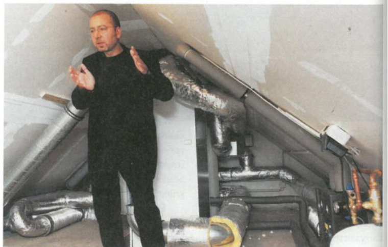
Platz spendend: Erol Serpil hat die gesamte Haustechnik auf dem Dachboden untergebracht.
