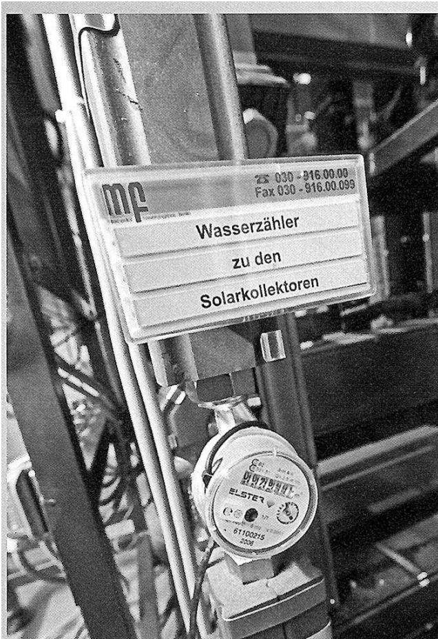
Professionelles Wärmemanagement: In der Energiezentrale im Keller des Berliner Hauses werden die Wasserströme überprüft.
