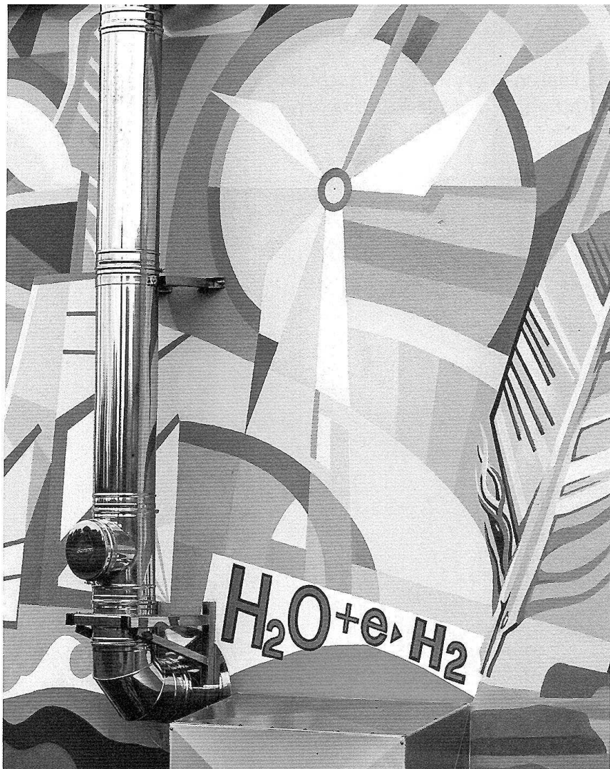
Windspeicher: Hinter der bunten Fassade wird im Rahmen des Demonstrationsprojekts RH2-WKA überschüssiger Strom aus einem Windpark nördlich von Neubrandenburg in speicherbaren Wasserstoff umgewandelt.
