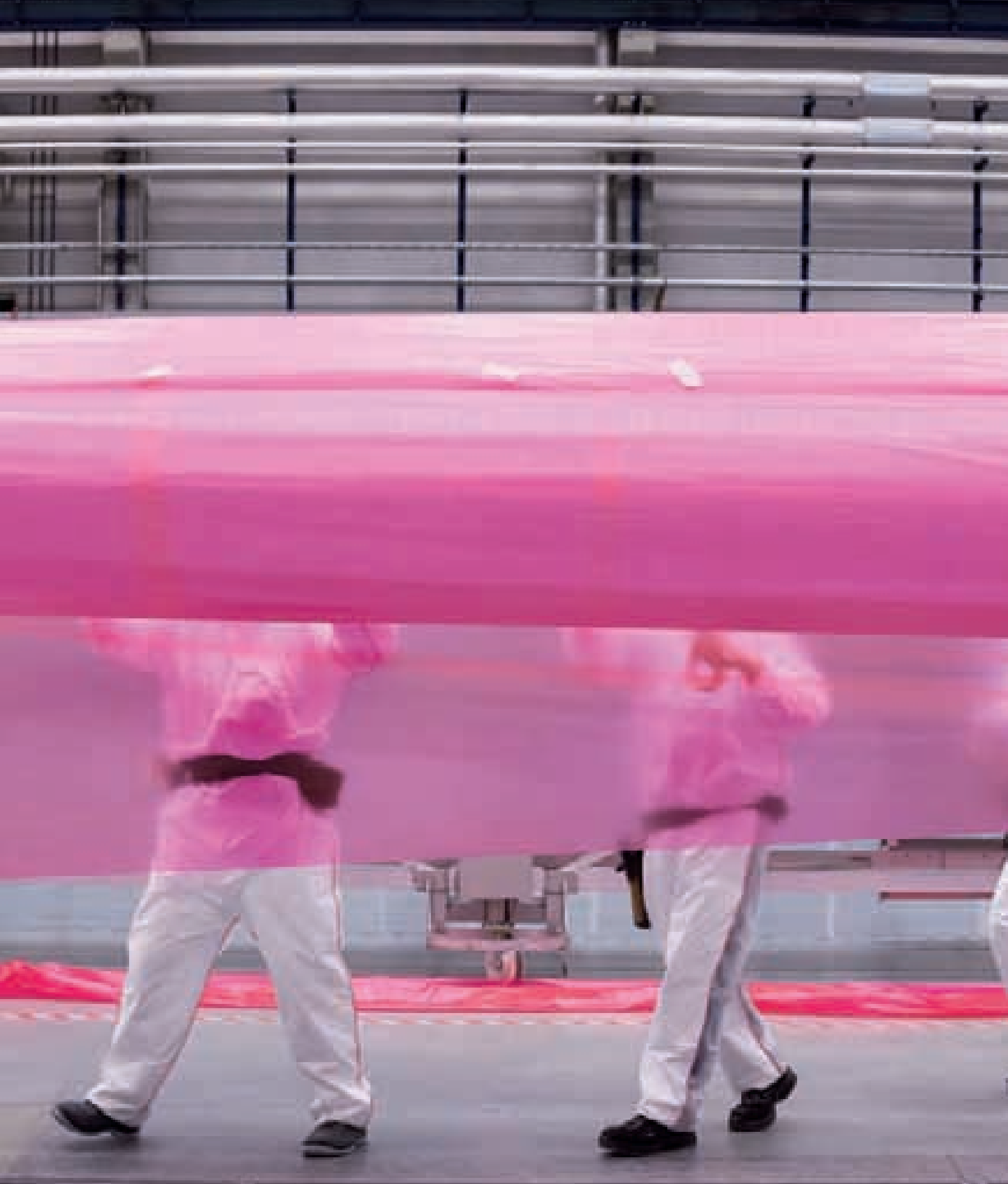
Teamarbeit: Hier – wie auch auf dem Bild links – wird während des Baus des Hauptbalkens eine perforierte Folie angebracht.
