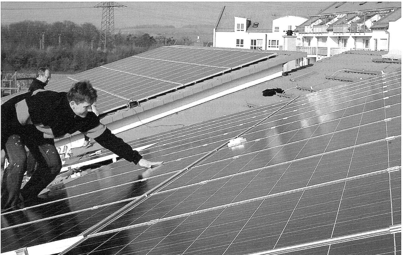
Im Visier: Installateure machen bei der Montage oft Fehler. Sie sollen sich daher fortan an einen neuen Leitfaden der Versicherungswirtschaft halten.
