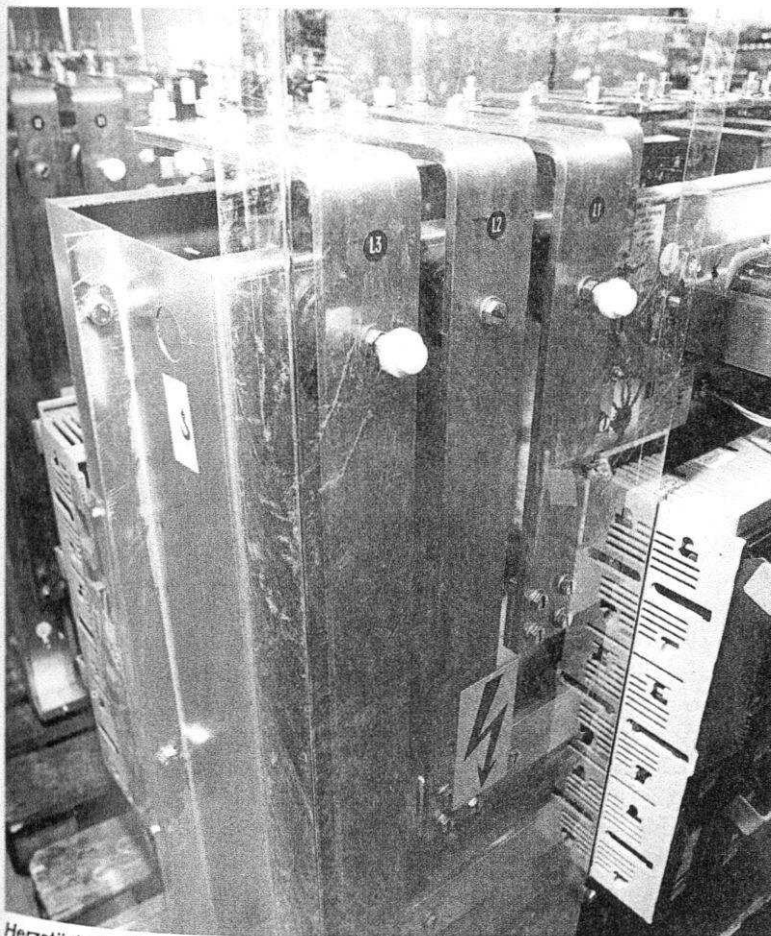
Herzstück der Windmühlen-Elektrik: Mittelspannungs-Anlage für die Trafostation einer Turbine
