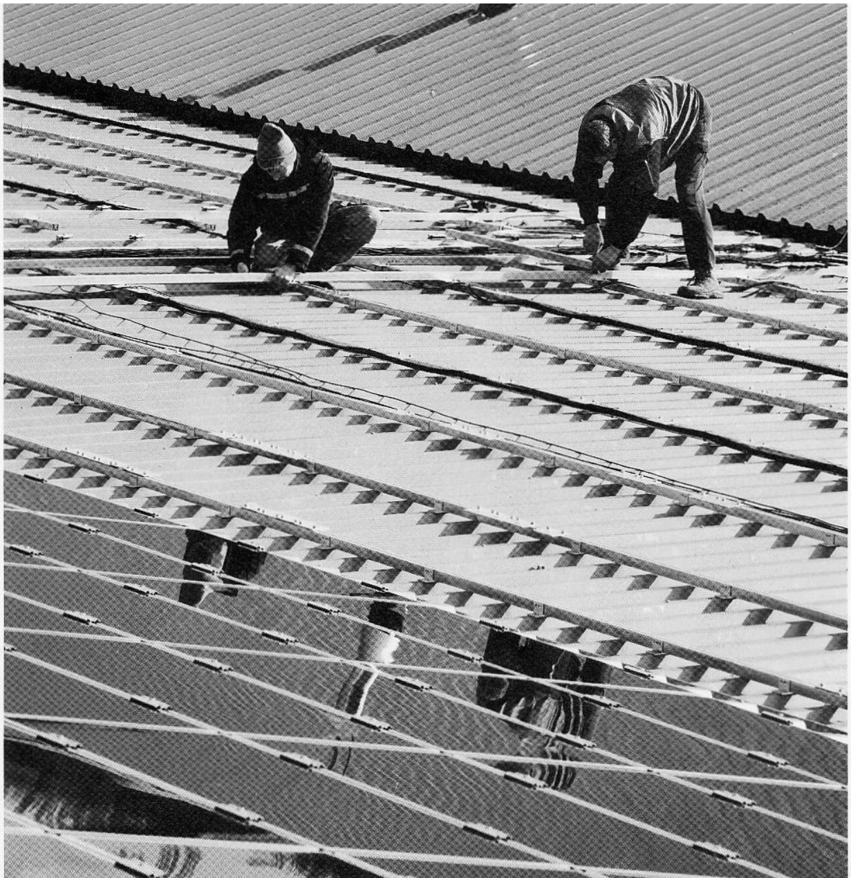
Einbruch erwartet: Müssen die Nutzer auf selbsterzeugten Solarstrom EEG-Umlage zahlen, lohnen sich viele Dachanlagen nicht mehr.
