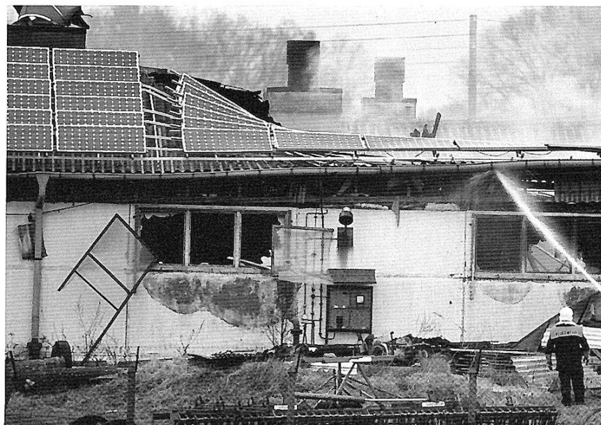
Feuergefahr: Falsch montiert, können PV-Anlagen Brände auslösen.
